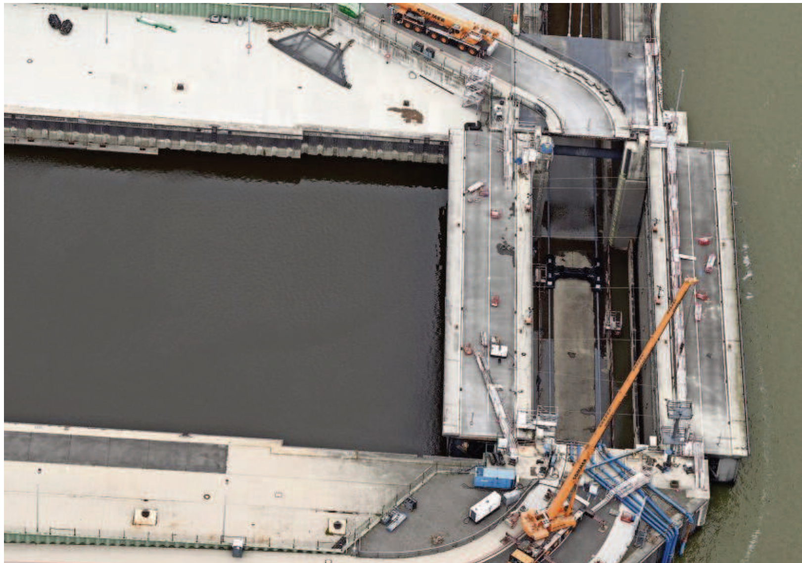
Blick frei bis auf die Docksohle des Binnenhauptes der Kaiserschleuse: Inzwischen ist das Schienen- und Unterwagensystem des Hauptes saniert und wieder am Platz. Fotos: Scheer
