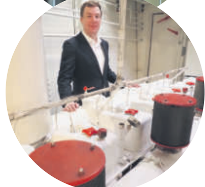
Im Maschinenraum der „Horus“: Florian Watermann stellt die schwere Technik vor.
