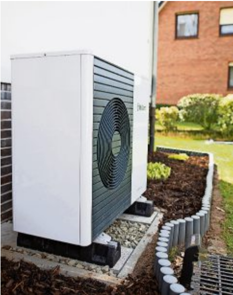
Vor einem Einfamilienhaus ist ein Außengerät einer Wärmepumpenanlage installiert. Foto: Reinhardt
